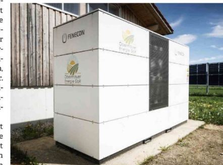
Der Batteriespeicher dient ausschließlich zur Zwischenspeicherung.
